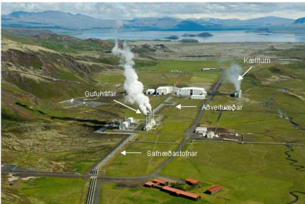
Mynd 12.11 Dæmi um aðveituæðar. Myndin er tekið á Nesjavöllum og sýnir safnæðar að skiljustöð, gufuháfa og aðveituæðar að stöðvarhúsi. Á myndinni sjást einnig fjórir gufuháfar.
